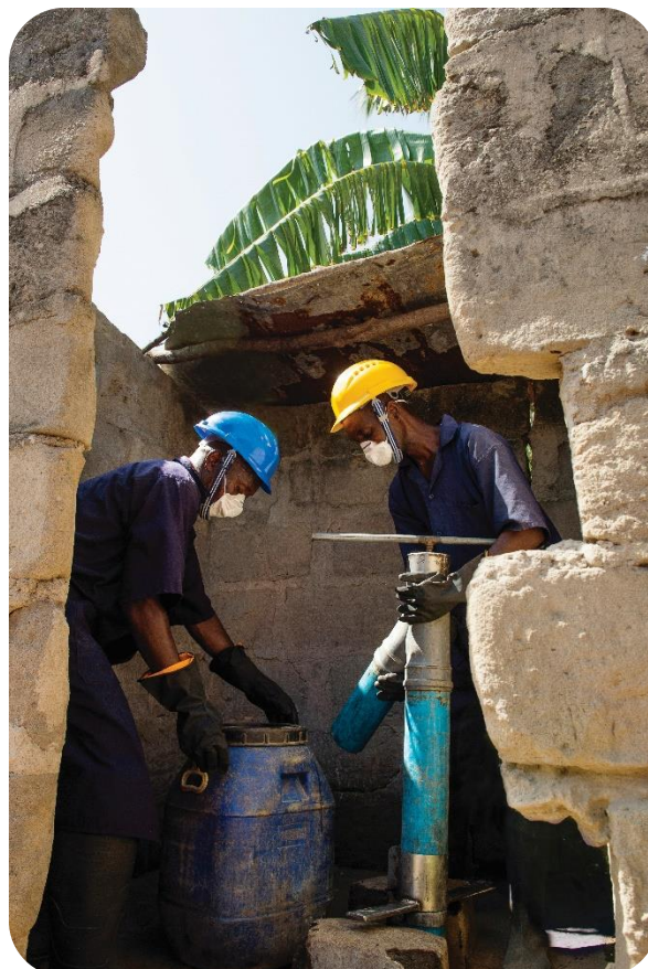
Julius Chisengo, responsable du groupe UMAWA, (à gauche) et Cleophas Shinga, responsable du groupe UMAWA, (à droite), commencent à vider une fosse de toilettes sèches à Kigamboni Ward, municipalité de Temeke, Dar es Salaam, Tanzanie.
